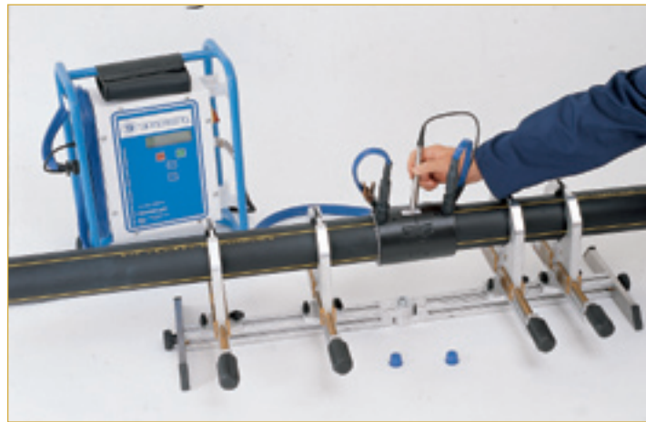
Welding using the Deltamatic by Unidelta Schweißtest mit einer Schweißmaschine Unidelta Deltamatic Пробная сварка с помощью сварочной машины Unidelta Deltamatic
